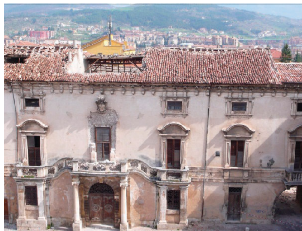
Palazzo Ardinghelli, gravemente danneggiato dopo il terremoto del 2009
